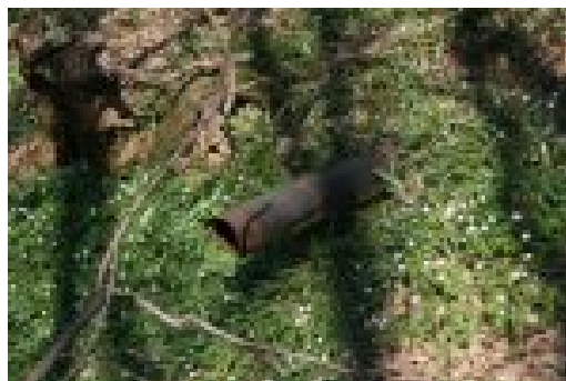
Resti di vecchie tubature
